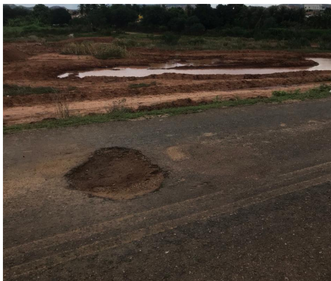
Figura 55: Situação precária da pavimentação da via Enéas Pereira, a principal do local.
