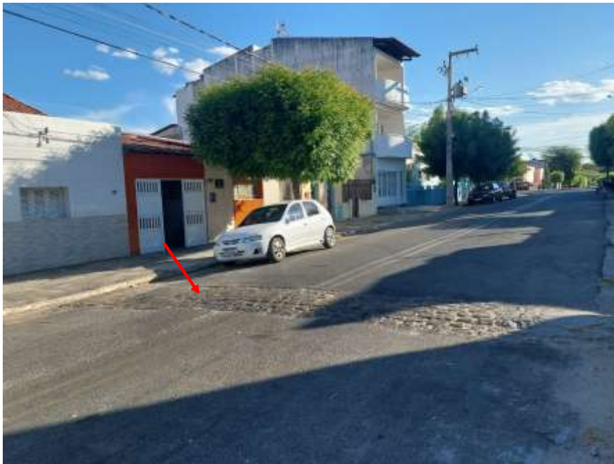
Figura 22 - Ondulação transversal sem pavimentação.
