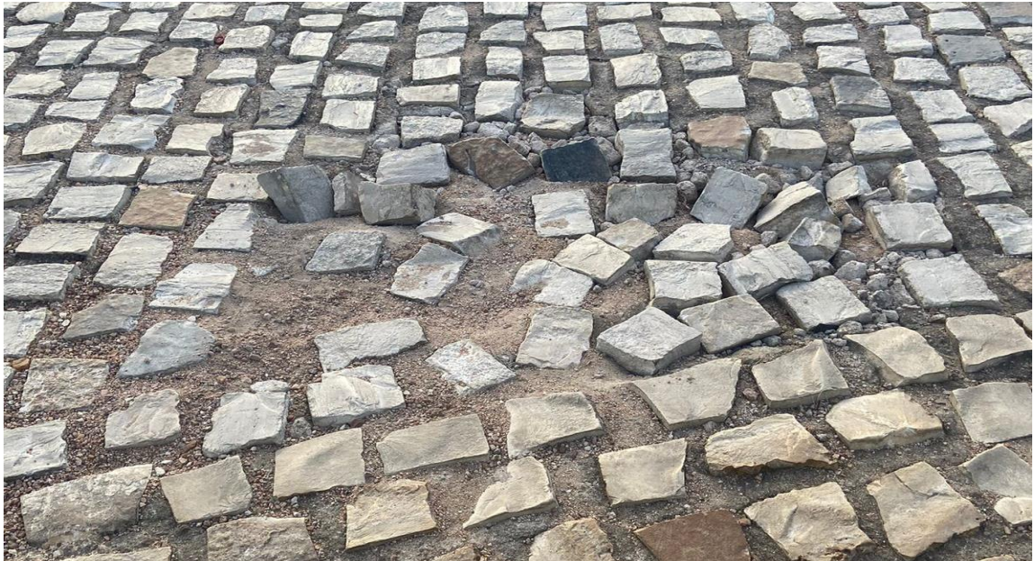
Figura 17: Juntas sem preenchimento com aparecimento de Panelas
